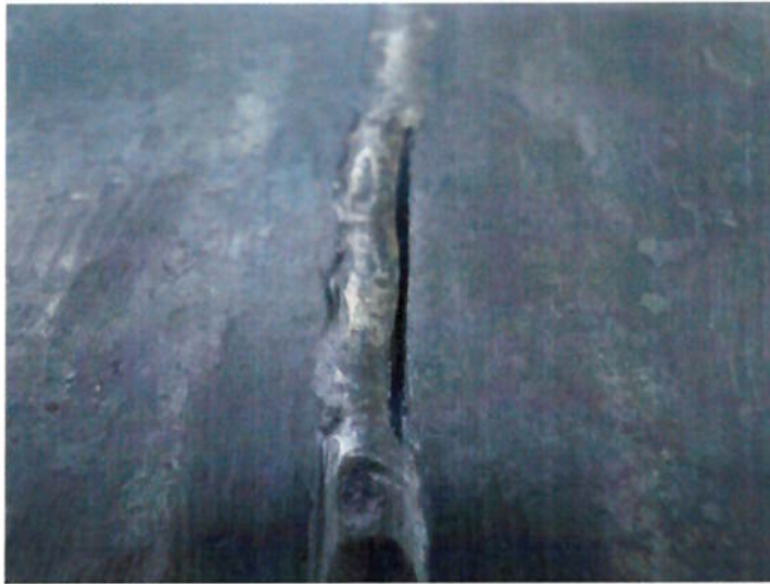
Figura 2.11 – Falta de fusão Fonte: Poliend
