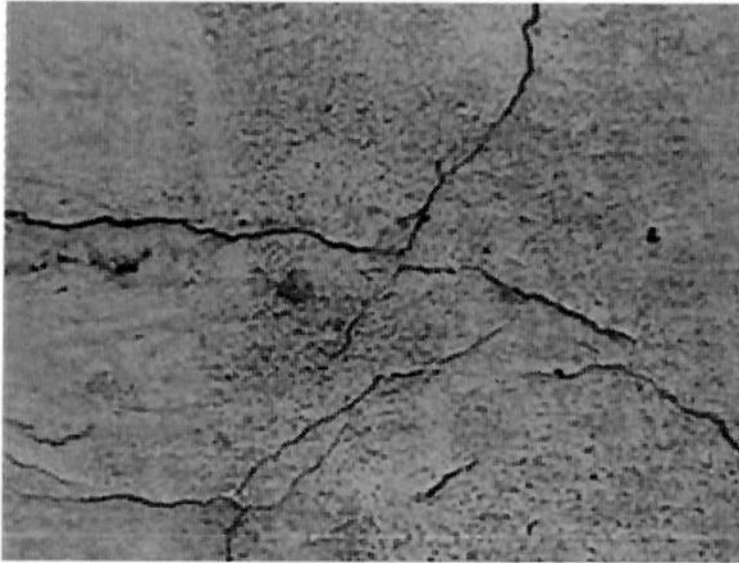
Figura 2.4 – Trinca Ramificada (Fonte: Poliend)
